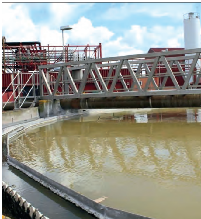
Cheminovas biologiske rensningsanlæg.
