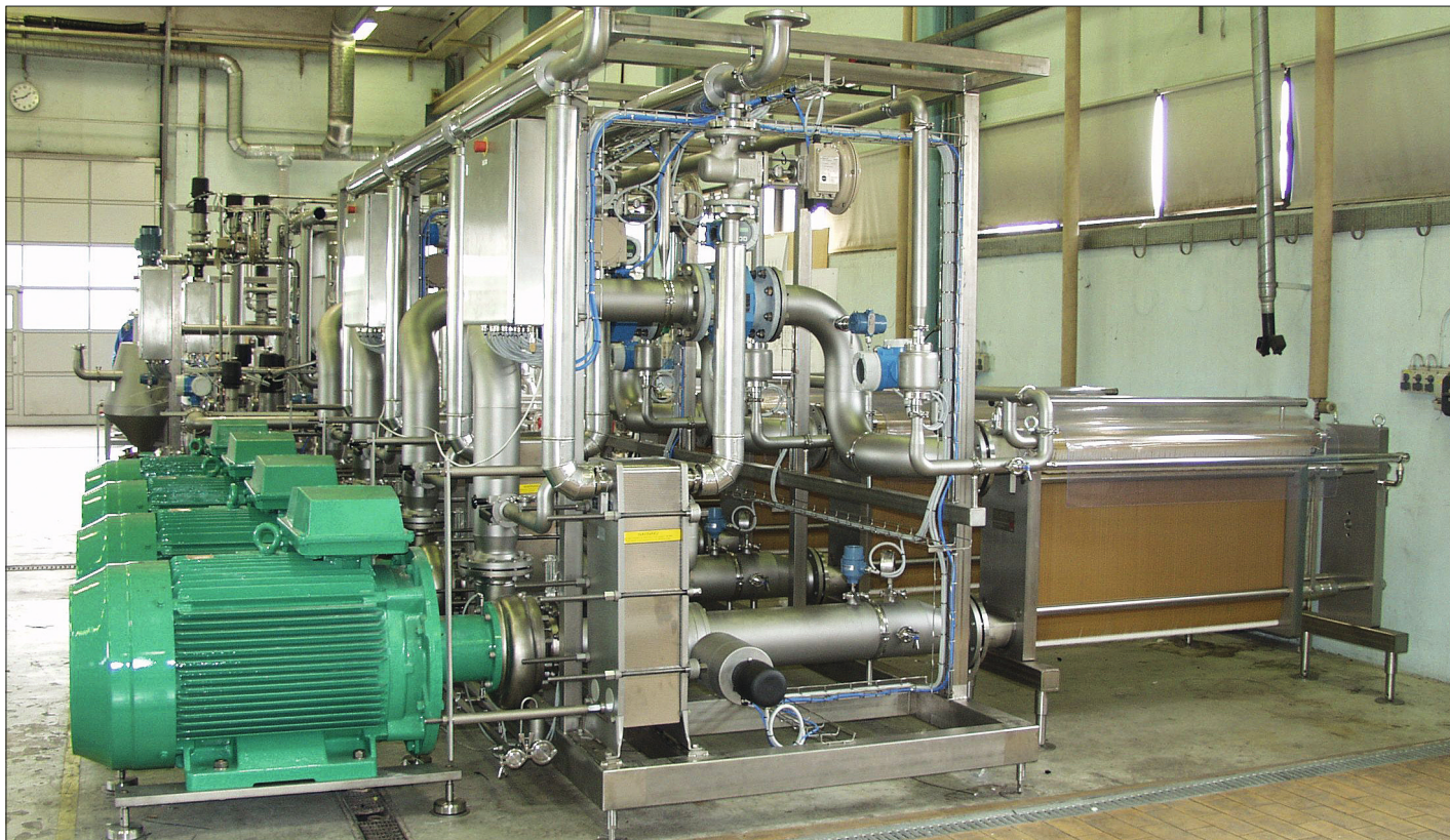
Installation af Alfa Laval M39-modul til fermenteringsindustrien.
