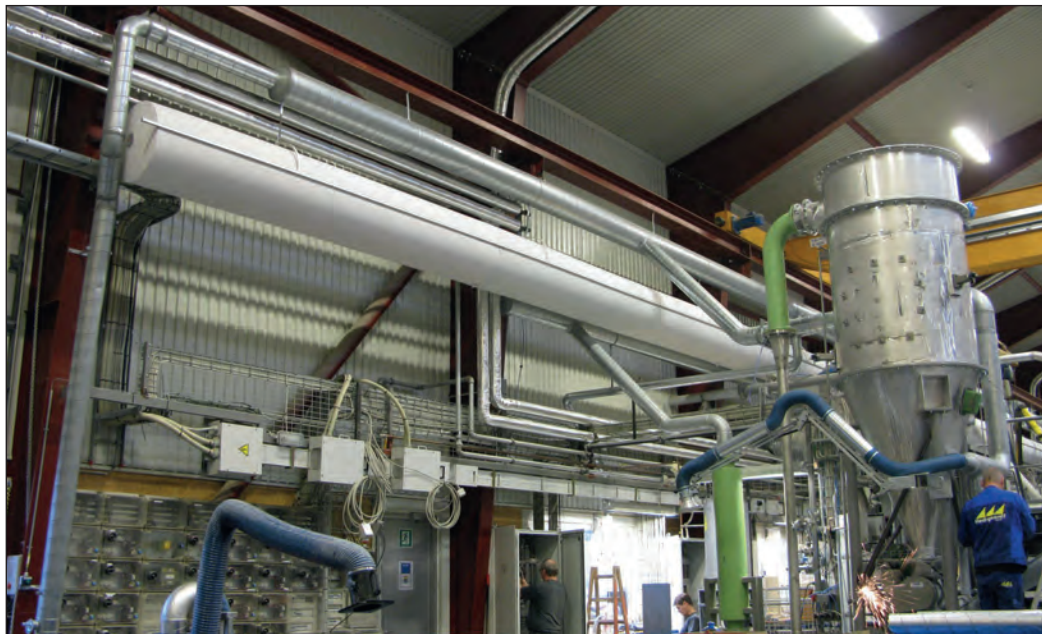
Sensorerne kommunikerer løbende med en masterenhed, der står et sted i bygningen.
