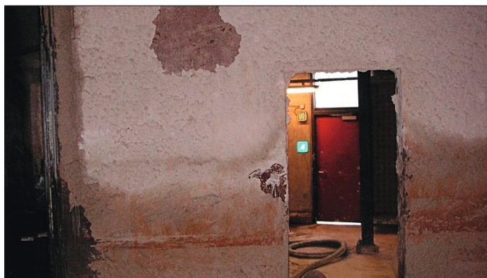
Figur 3. Illustration af belægninger på indersiden af røggaskanal umiddelbart før afsvovlingsanlægget, fremkaldt af skumdannelse og den resulterende overførsel af partikler.
