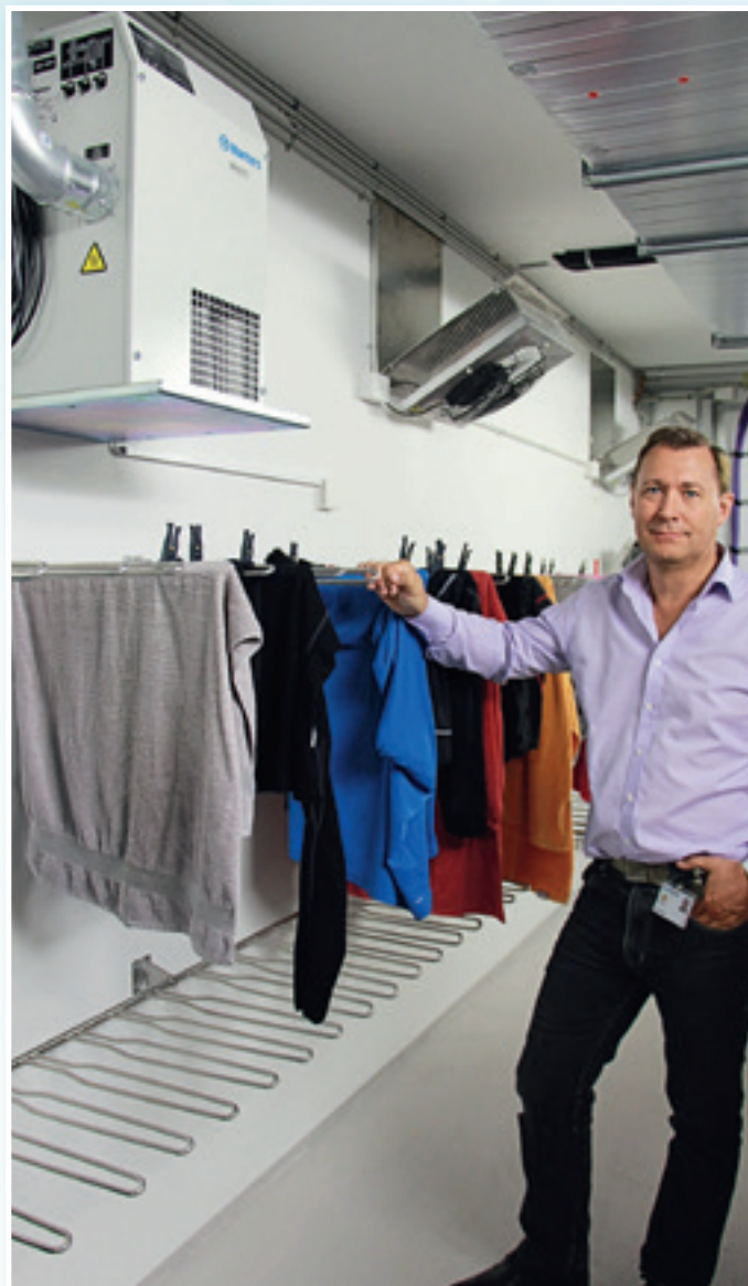
Hos Siemens A/S i Ballerup har projektleder Michael Götz stået for indkøb af udstyret til tørrerummet og udtrykker stor tilfredshed med løsningen.
