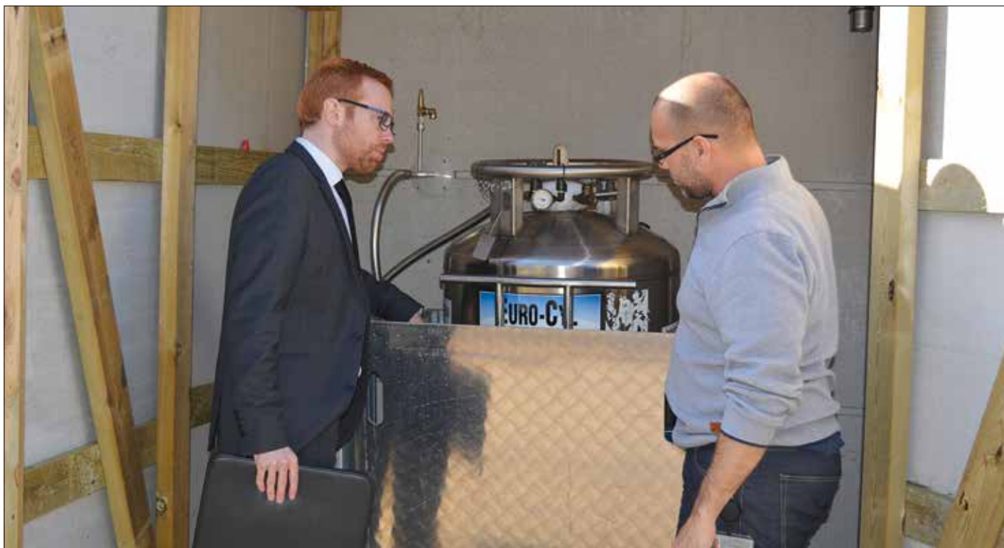
Henrik Thellemann fra AGA, sammen med Facility Manager Michael Andersen fra Bavarian Nordic, foran et af virksomhedens oplag af flydende nitrogen, som forsyner en lavtemperaturfryser i bygningen. Her er en af oxygendetektorerne monteret ved fryseren.
