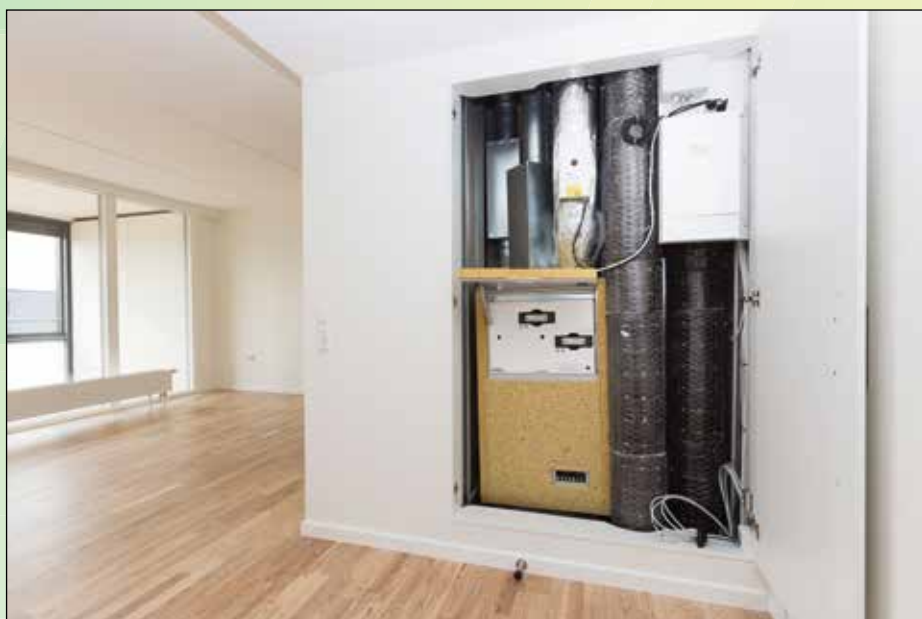
Et HCV 4 Low Sound anlæg placeret i et køkkenskab. Anlægget er beklædt med et lydisolerende materiale, så det overholder standarden i BR 10.
