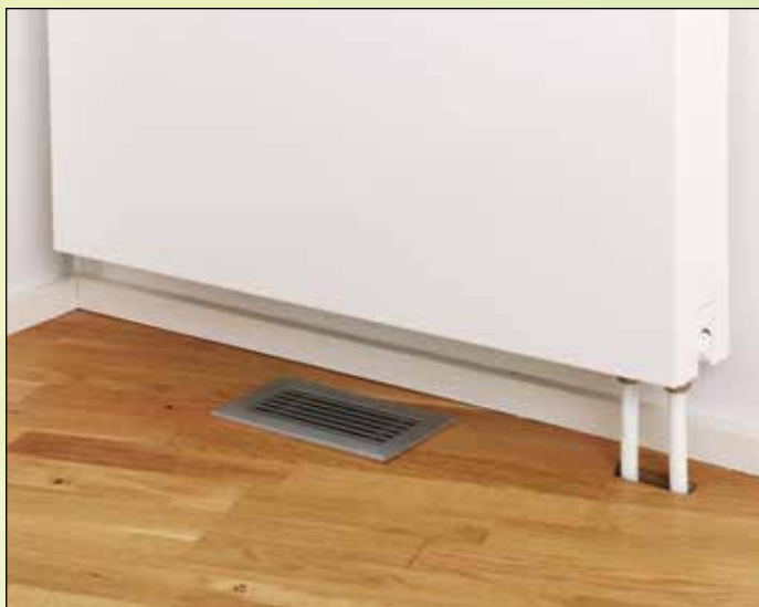
Diskrete indblæsningsbokse sørger for, at luften i lejlighederne bliver erstattet med frisk luft.
