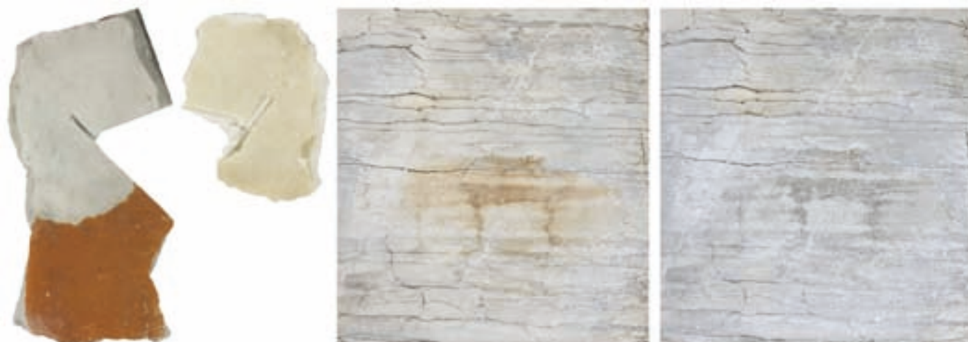
Figur 3. Til venstre ses rustbelagt grønlandsk marmor fra Overformynderiet med et afrenset og uafrenset område, samt kompresset der nu indeholder det afrensede rust. I midten ses et område af Marmorkirken før afrensning, og til højre efter afrensning.
