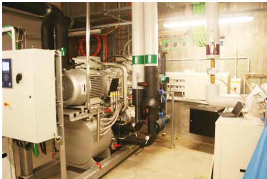
Dette er et af de tre backup-systemer til kølingen. Foto: Erik Pingel.
