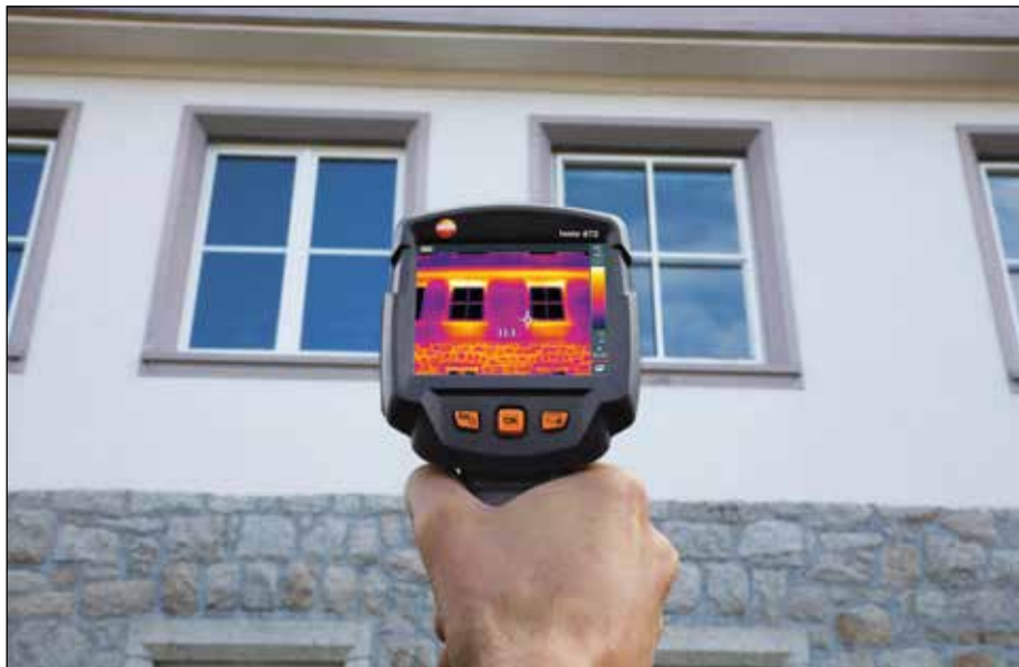
Kuldebroer, utætte vinduer og døre er de helt store syndere, når det gælder tab af værdifuld energi og negativ effekt på beboernes komfortniveau.
