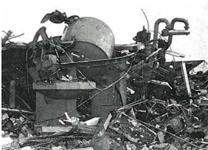
Intet var uskad i den eksplosionsramte bygning. Kilde: [3].
