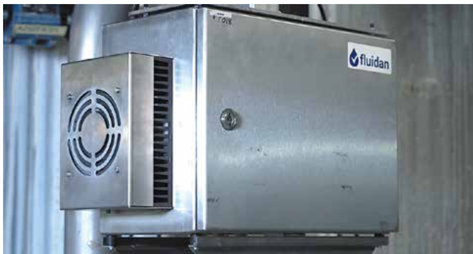
Det nye kapillarreometer installeret i en malingfabrik.
