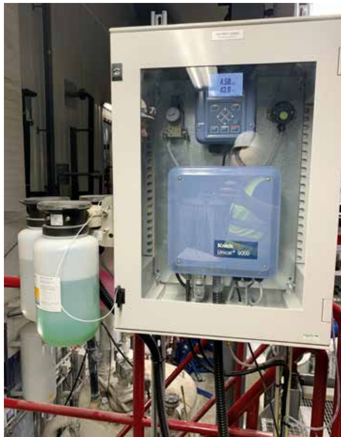
Nærbillede af et af de seks fuldautomatiske pH-måleanlæg, der er installeret hos Fjernvarme Fyn.
