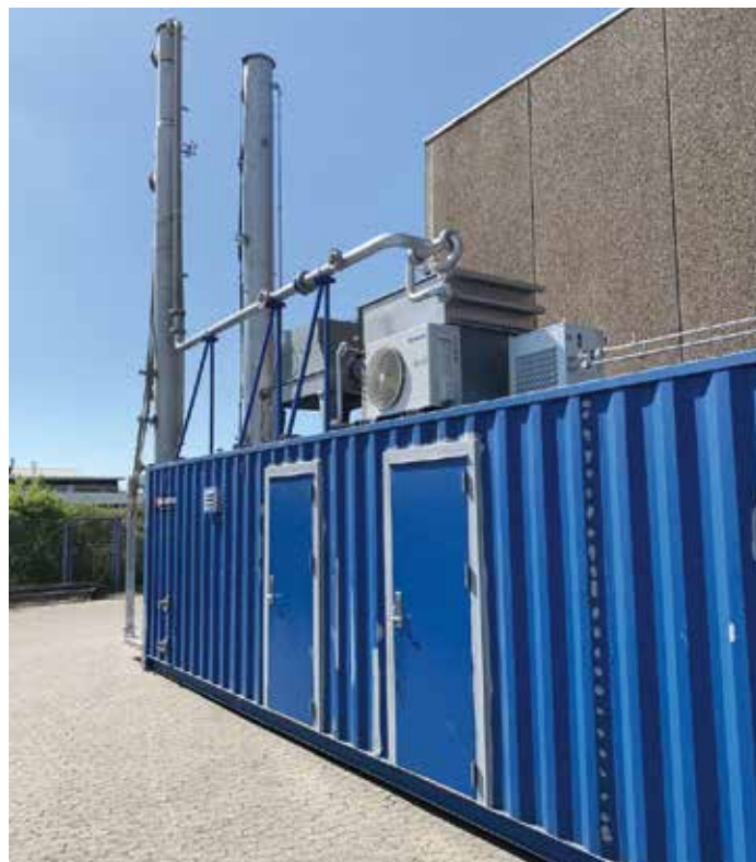
Test af CC på Kraftvarmeværk Thisted. CO 2 fra 1 procent af værket udskilles med op til 99 procent effektivitet på et anlæg udlånt af Ammongas A/S. Ammongas A/S har netop modtaget Fjernvarmeprisen 2021 sammen med SEG A/S.
