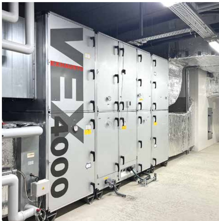
Tre VEX4000-aggregater leverer godt indeklima til Bravidas bæredygtige domicil i Brabrand - en løsning, der er blevet til i et tæt samarbejde mellem Bravidas projektteam og Exhaustos kundeteam.
