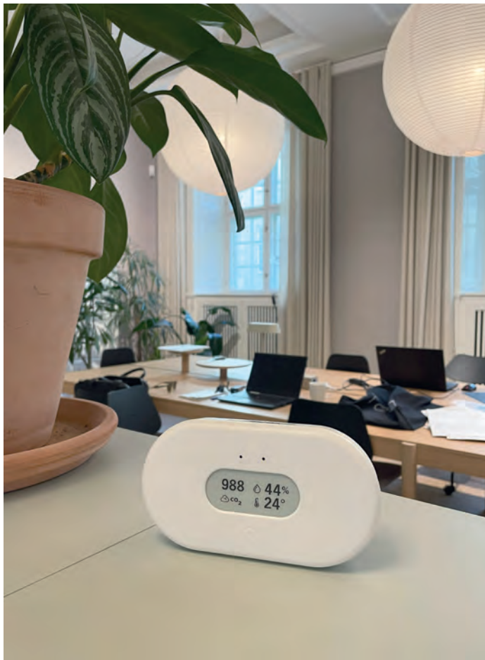
Avanceret sensor installeret for at måle og overvåge indeklimafaktorer som fugtighed, temperatur og luftkvalitet.
