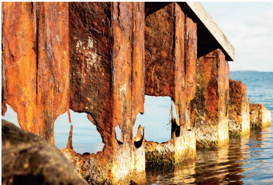
Figur 3. Korrosion på en ubeskyttet spunsvæg i tidevandszonen. En monopæl vil aldrig opleve en så alvorlig situation med gennemtæring, men det viser, hvor alvorlig korrosionen er i dette område og understreger vigtigheden af ordentlig korrosionsbeskyttelse.
