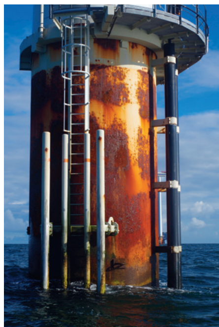
Figur 4. Toppen af et overgangsstykke på en monopæl, hvor malingsspecifikationen var forkert. Efter kun 14 års brug (2016) i Nordsøen ses der betydelig fremskreden korrosion [11].
