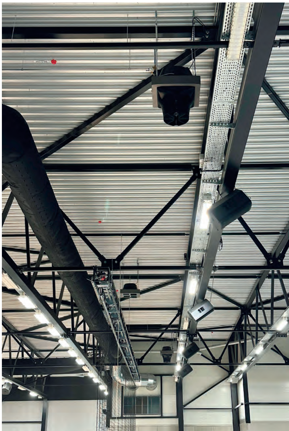
LEO-varmeventilatorerne med sorte turbobodyser og LEO-opblandingsventilatorerne falder godt ind med loftkonstruktionen i den højloftede GOG-arena.
